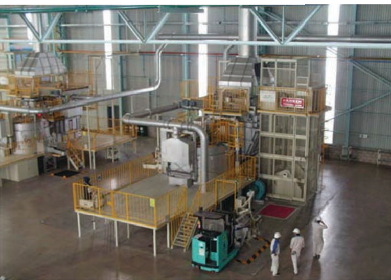
Fig.8: Instalación de Horno Meltower estático con plataformas y equipamiento auxiliar
